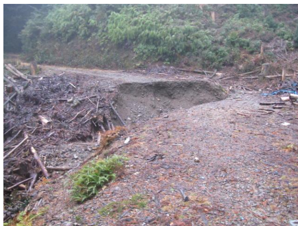
図 2 初代坂下隧道西側にて崩壊した路盤
